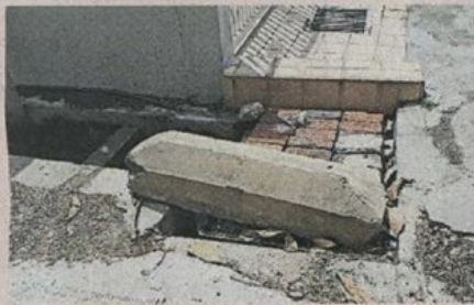
► 蒲种钻石花园第二期6路的沟渠已崩塌, 摇摇欲坠。
